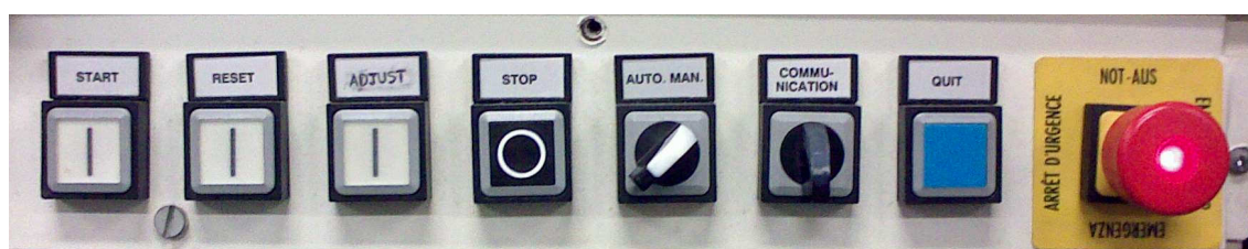
Figura 17 – Painel de controle local
